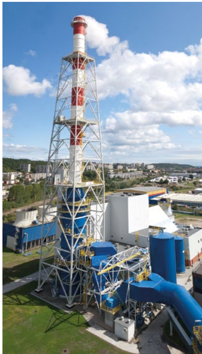
Instalacja odsiarczania spalin (IMOS) w EC Gdyńskiej
