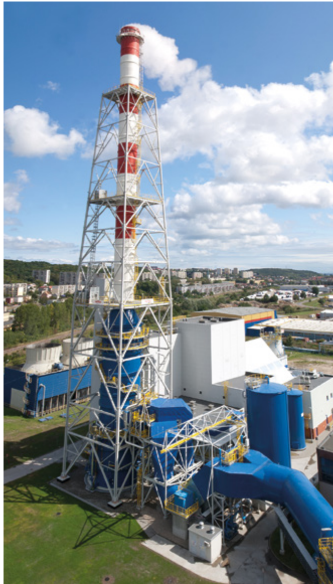
Instalacja odsiarczania spalin (IMOS) w EC Gdyńskiej
